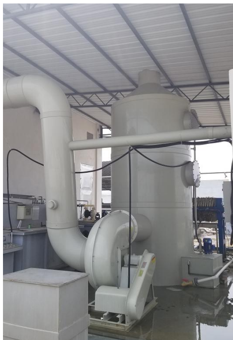
图 5-3 喷淋塔现场图
